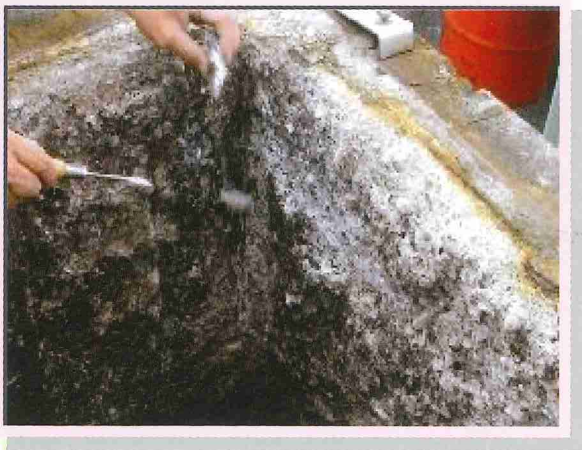
化学的腐食によるコンクリートの劣化
